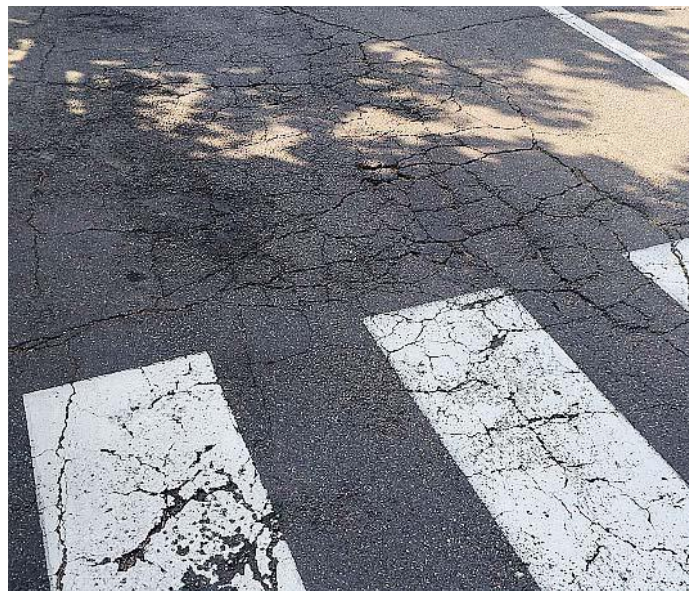
DISSESTI L'immagine di una strada piena di buche
