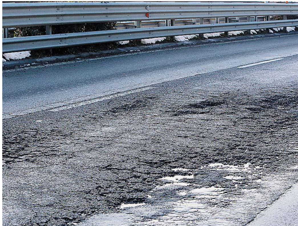
DETERIORATO Alcune immagini delle buche in tangenziale
