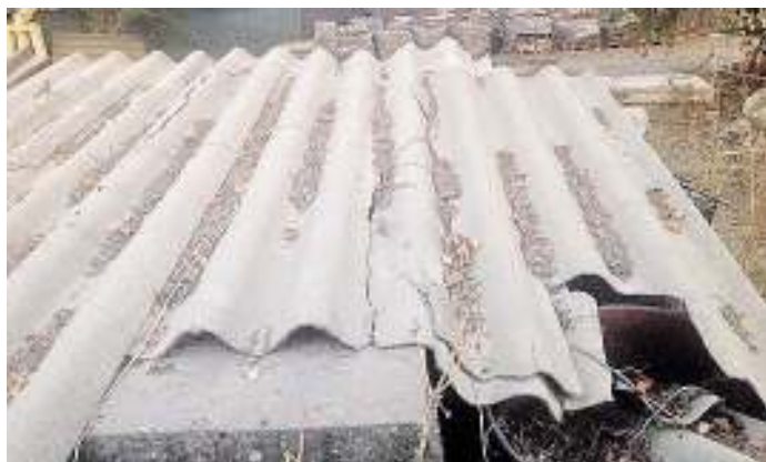
COPERTURA Un tetto con presenze di amianto
