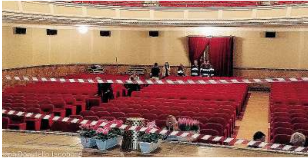
CHIUSO L'interno del Carani la sera di ottobre del 2014 in cui crollò una porzione di controsoffitto
