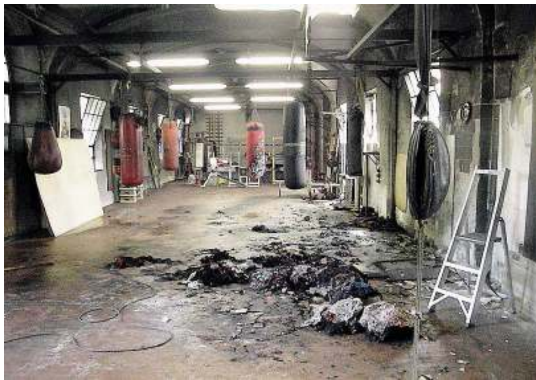
DANNI INGENTI La palestra di via Pio Donati nelle ore successive all'incendio
