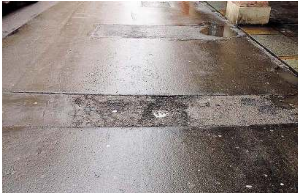
BUCHÉ Alcune delle voragini presenti in via Canalino
