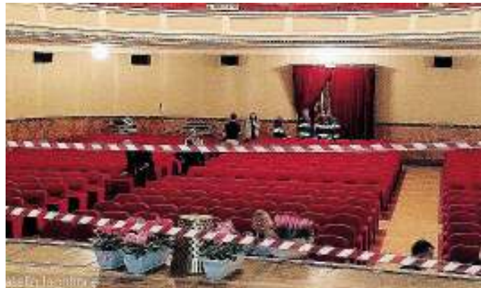
OUT Il teatro la sera del crollo del controsoffitto
