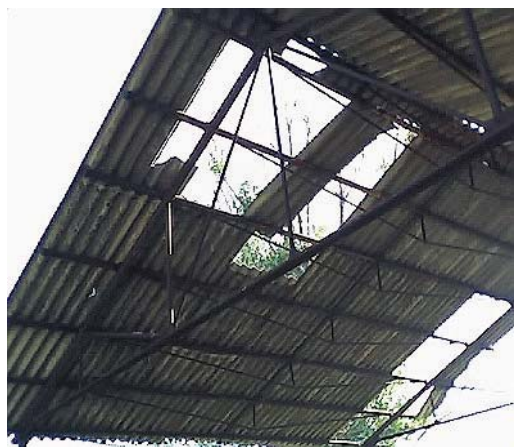
COPERTURA Amianto su una tettoia
