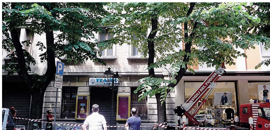
CALCINACCI Il momento del crollo di detriti dal cornicione
