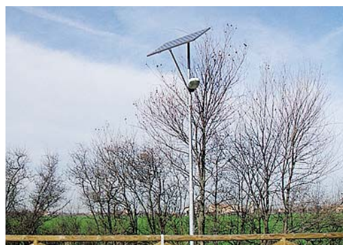
LADRI I pannelli fotovoltaici
