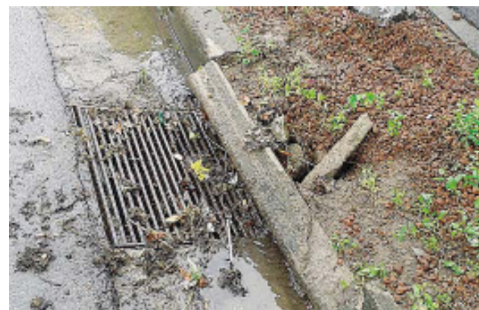
DANNI | Alcune immagini dell'allagamento e delle scoline sporche
