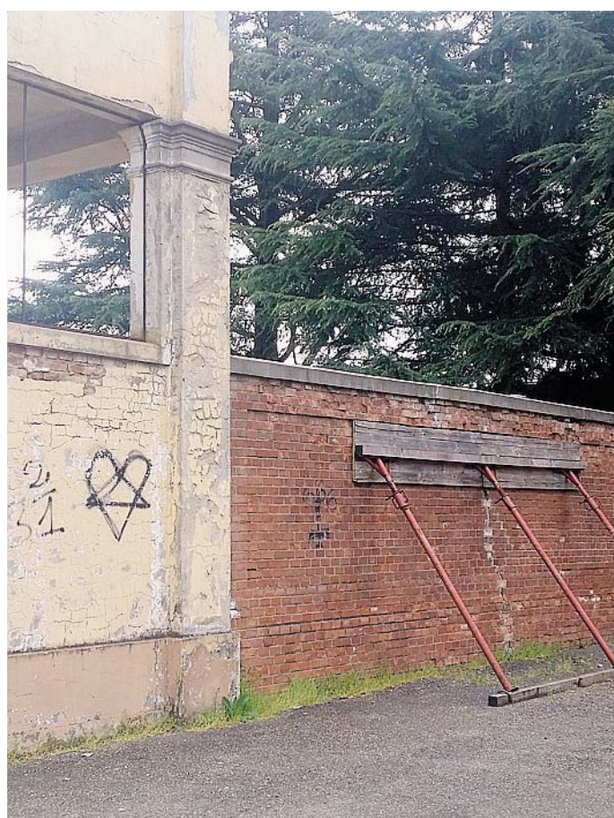
SOSTEGNI Un'immagine dell'interno del cimitero con il muretto puntellato
