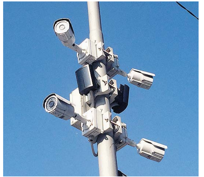
IMPIANTI Le telecamere fisse installate nel territorio cavezzese
