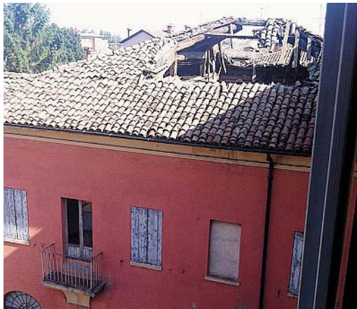
CROLLO Il tetto crollato
