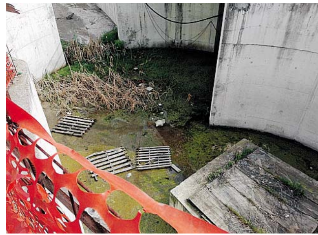
DEGRADO Il pericoloso invaso di acqua stagnante che si è creato nel cantiere
